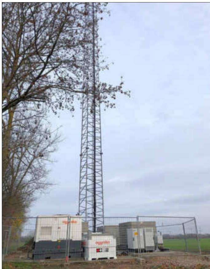
Provisorischer Mobilfunkmast in Zitterpenningshagen
